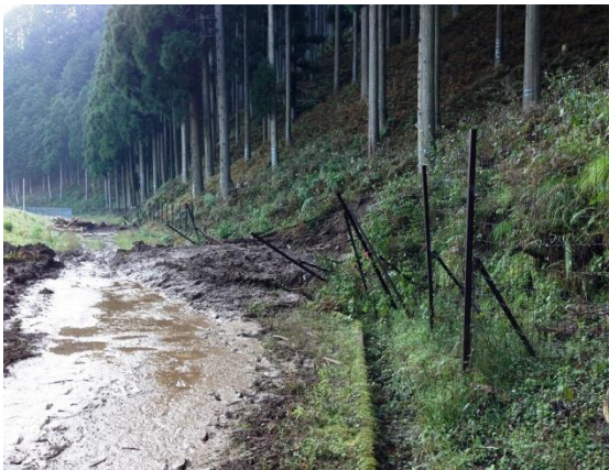
図 2 7 金網柵が破損し、 侵入可能になっている
