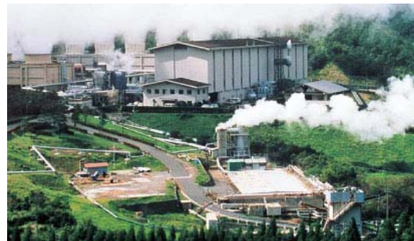
九州電力 / 八丁原地熱発電所
