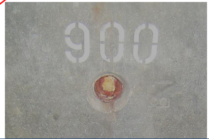
■ ドレーントンネル裏面排水口の詰まり
