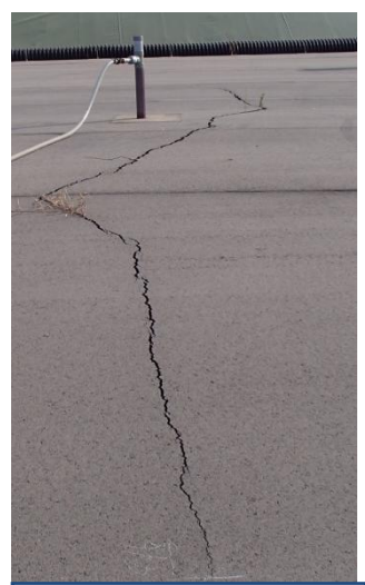
■ アスファルトのクラック
