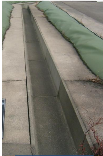
■ 集排水路の隙間
