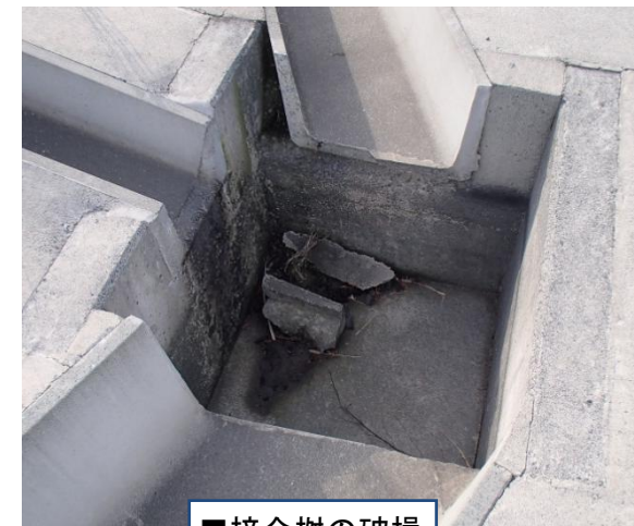
■ 接合部の破損
