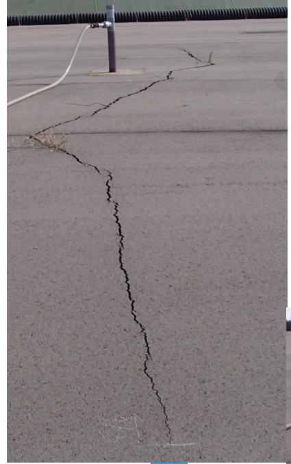
■ アスファルトのクラック
