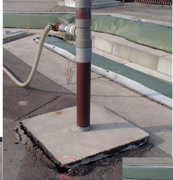
■ アスファルトとコンクリート基礎との隙間
