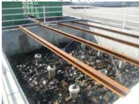
● 循環柵での散水状況
