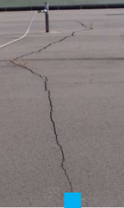
■ アスファルトのクラック
