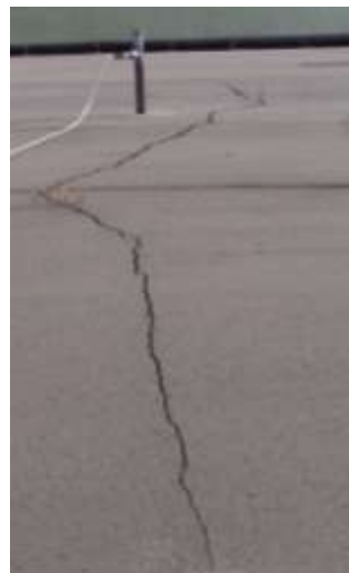
■アスファルトのクラック
