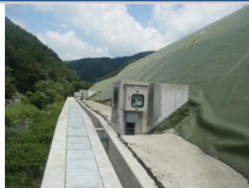
浸出水揚水井戸（下流側）
