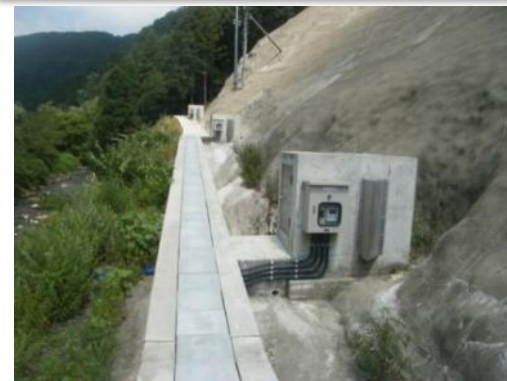
浸出水揚水井戸（上流側）
