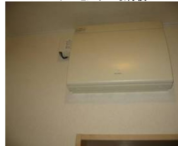
スマートELセンサー取付後
