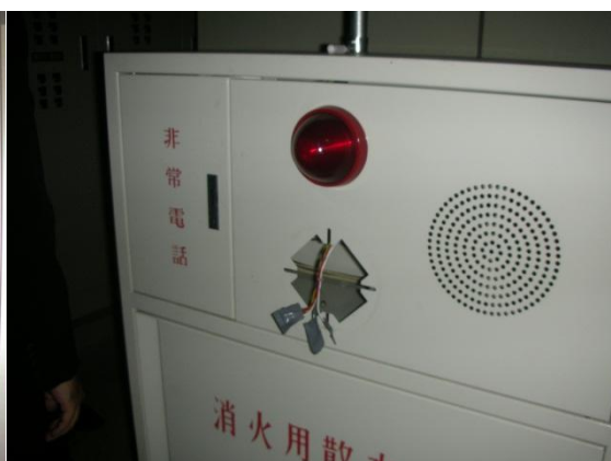
[破損している防災設備]
