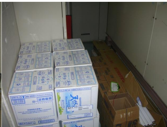
[消耗品が機械室等においてあるケース]
