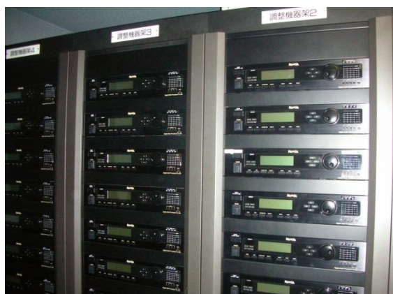
[サンドームの音響設備]
