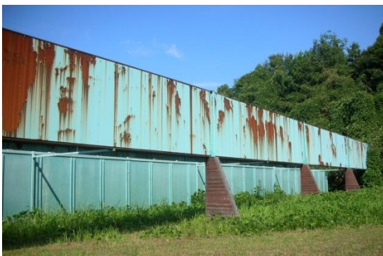
[塗装がはげ落ちている部分]
