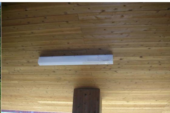
[割れている蛍光灯カバー]
