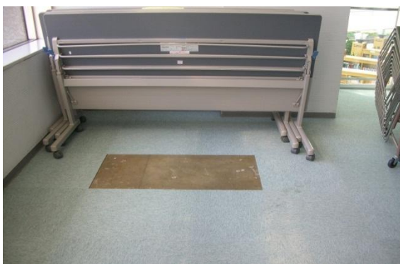
[修繕が必要な部分]
