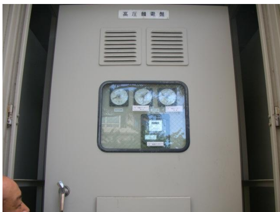
[電気メーター]
