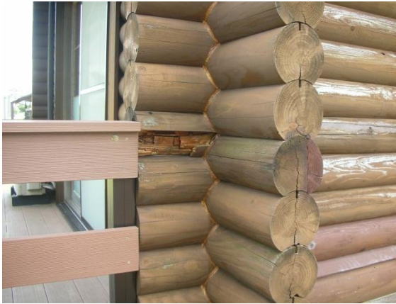
[ケビンの破損状況]
