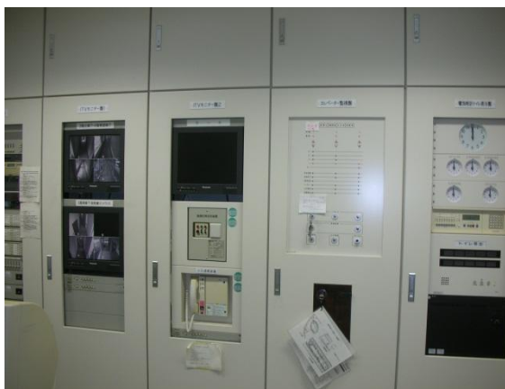
[空調設備・中央制御盤]
