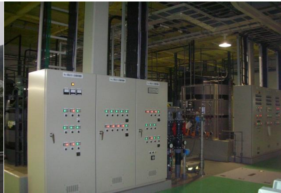
[水処理施設の設備]
