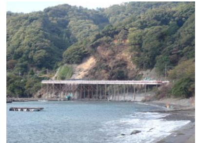
《台風18号災害で不通となった常神半島に設置した仮設道路》 (平成25年10月)
