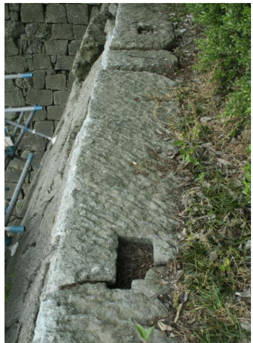
石垣天端石のほぞ穴（北地区）
