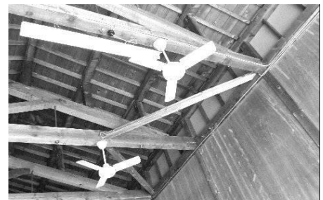
写真7. 天井設置の攪拌扇
