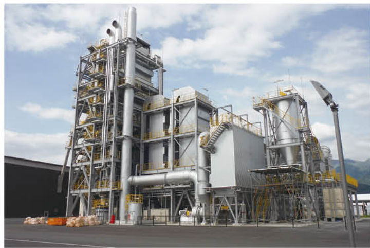
木質バイオマス発電所（大野市）
