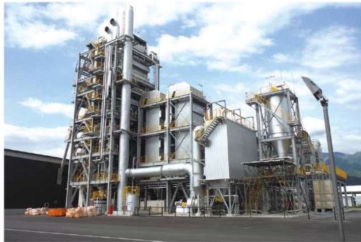
木質バイオマス発電所（大野市）
