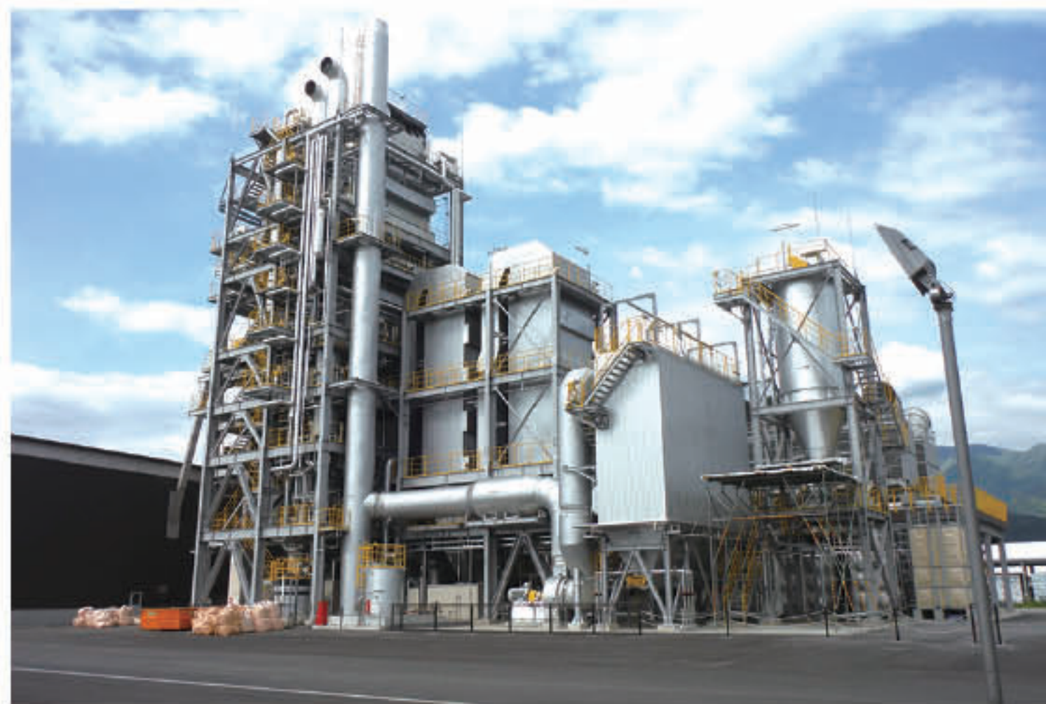
木質バイオマス発電所（大野市）
