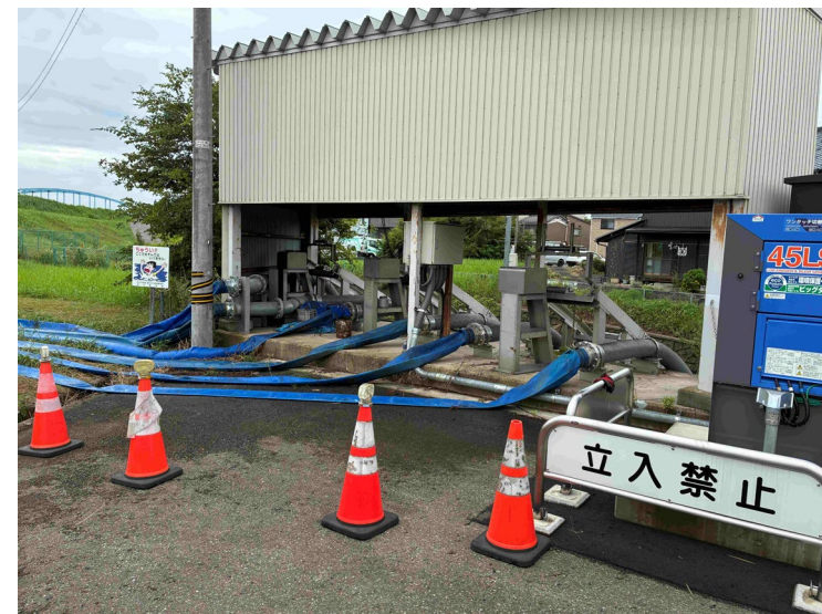
③ 芳野川樋門常設ポンプ 9月4日撮影
