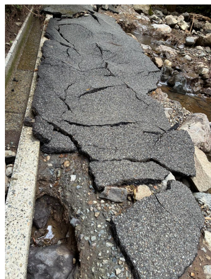
アスファルトが崩壊
