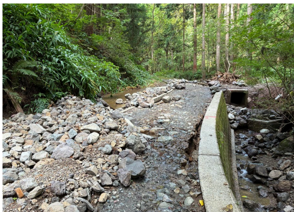
河川護岸と林道に隙間
