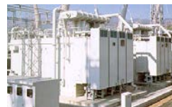
起動変圧器の例
