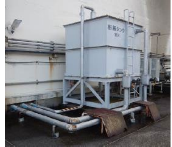
[膨張タンク（屋内給湯設備）]
