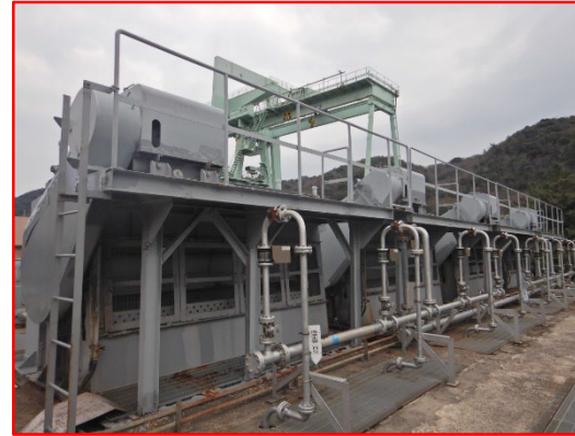
海水除塵装置
