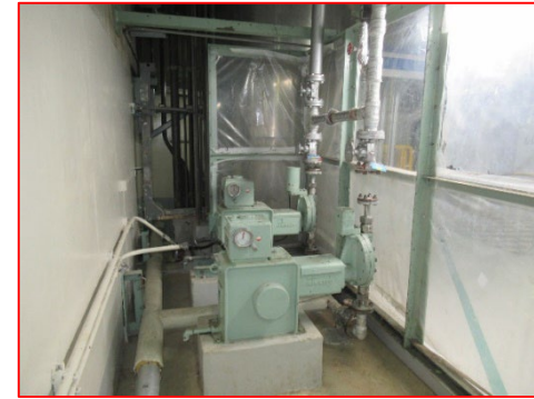
苛性ソーダ注入装置
