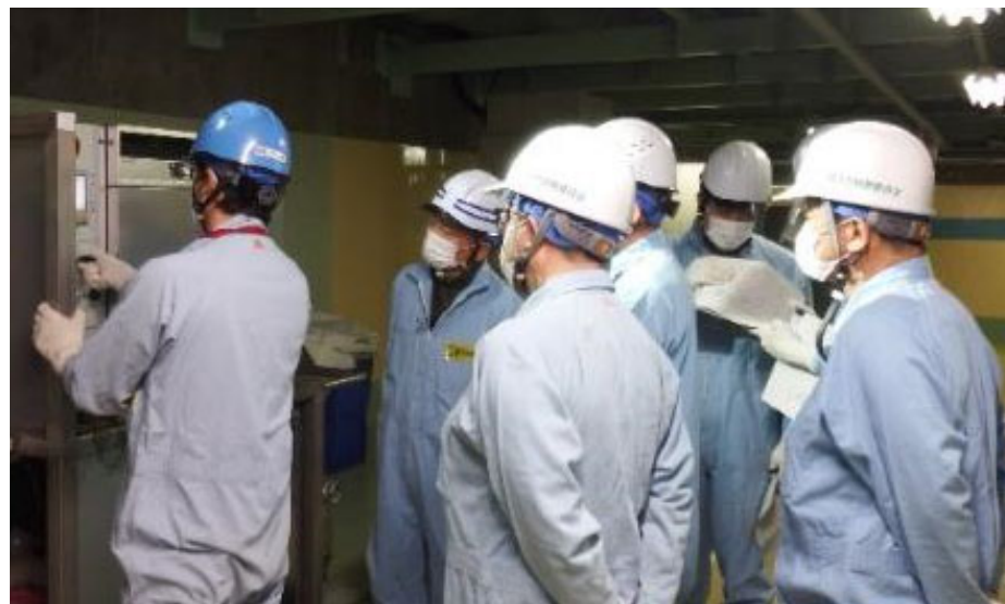
静的触媒式水素再結合装置 機能性能検査
