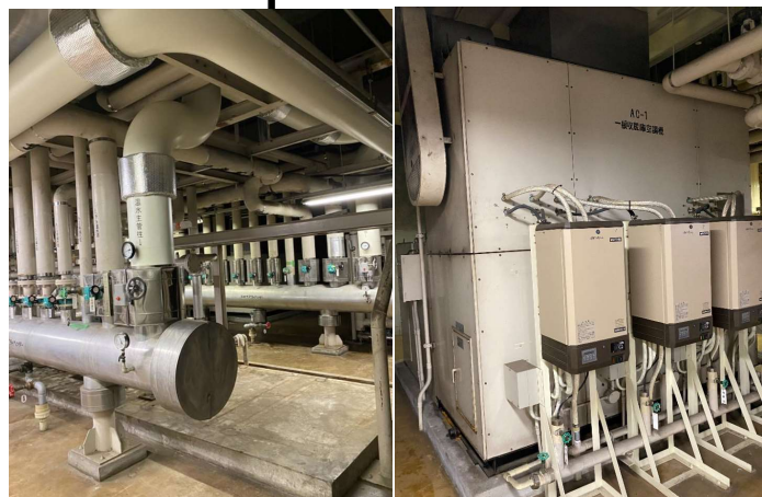
冷温水を循環させる古いタイプの設備。
