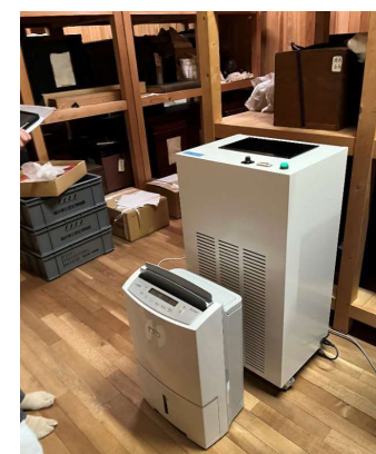
セパレート型の簡易空調設備
