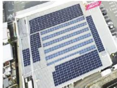
ハーツたけふ（越前市）の屋根に載る、自家発電用太陽光パネル。
