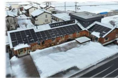
融雪機能付き太陽光パネル
