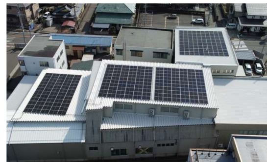
（太陽光発電設備）
