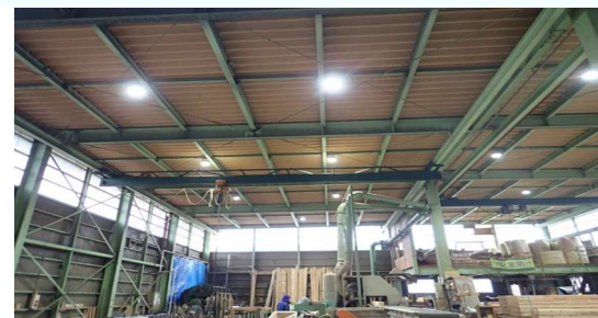
（工場のLED照明）
