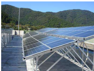
南中山小学校のプール跡地に設置した太陽光発電設備
