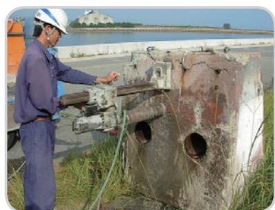
20~30年程度、海風にさらされていたコンクリート
