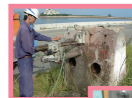
20~30年程度、海風にさらされていたコンクリート
