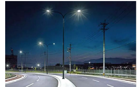
道路照明LED
