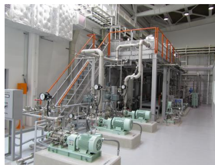
保守訓練設備（ループ設備）
