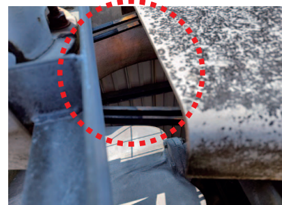
〈省エネ診断施設の冷却塔ファンベルト〉
