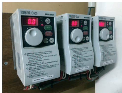
〈インバータ制御装置〉
