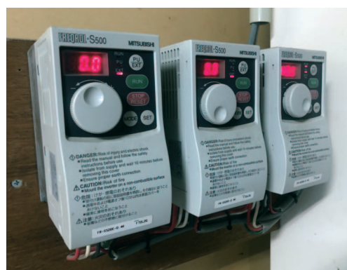
〈インバータ制御装置〉
