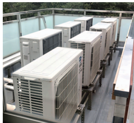
〈障害物がある室外機周辺〉
