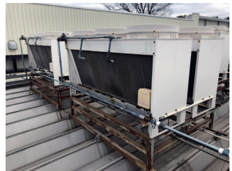
省エネ診断店舗では、冷凍機室外機に散水設備が設置されていました。
