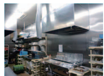
調理場の換気設備
