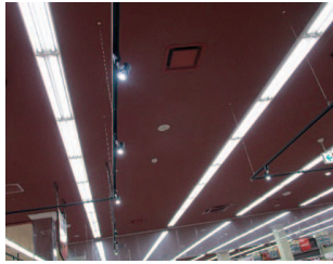
天井照明(省エネ診断店舗)
