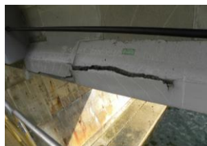
橋梁の老朽化
