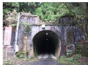
トンネルの老朽化
