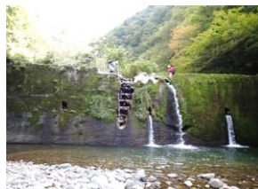
砂防堰堤の老朽化
