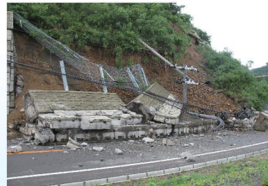
斜面崩壊 (平成18年7月 豪雨)
