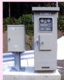
●消雪ポンプ制御装置
