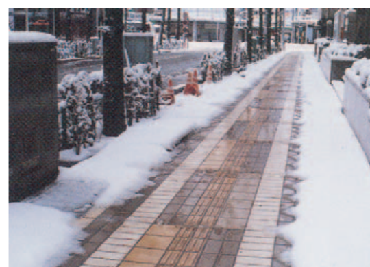
無散水消雪(福井市) 道路に埋設したパイプに地下水などを通して雪を融かします。
