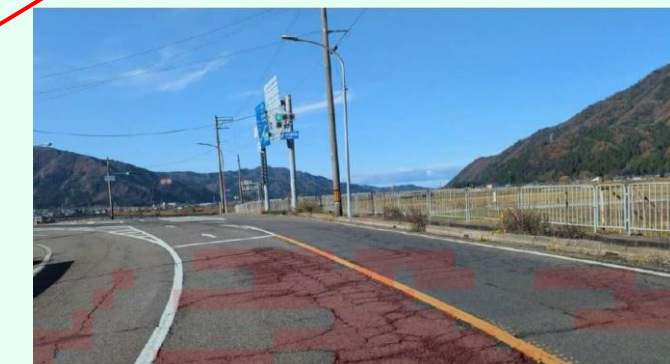
▲舗装損傷 AI検知イメージ
