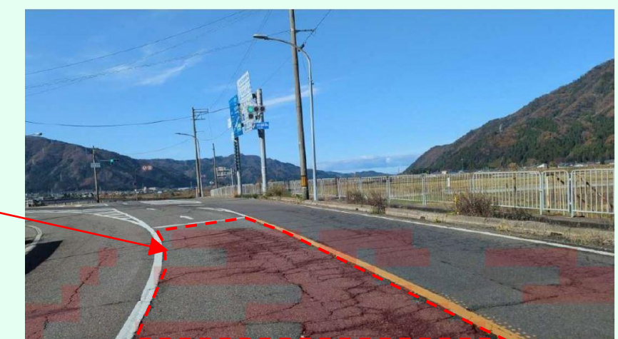
▲舗装損傷 AI検知イメージ
