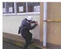
施設の被害状況調査
