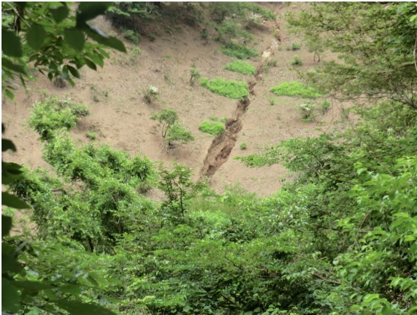
図 2 7 部分的な土壌流出が発生している様子
