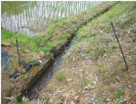
図 2 7 地形の変化点に支柱がなく、 電気柵と地面との隙間がある
