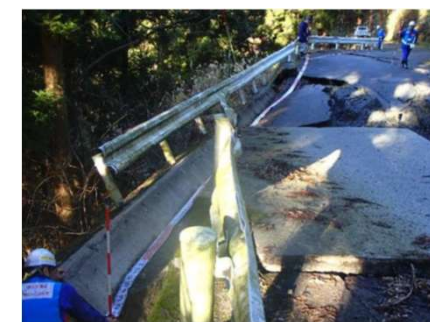
長野県北部地震における調査事例
