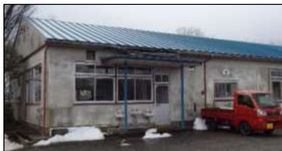
図1 老朽化した施設
