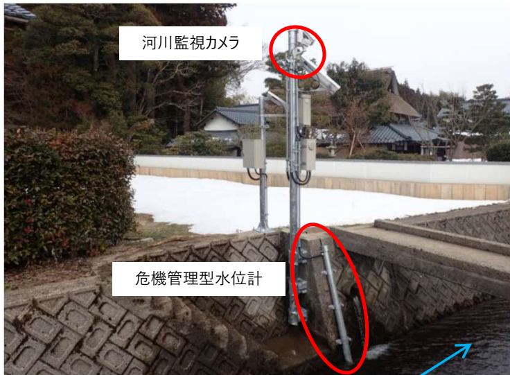
〈危機管理型水位計および河川監視カメラ設置状況〉
