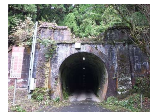
トンネルの老朽化
