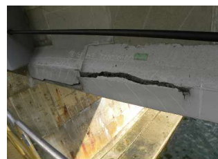
橋梁の老朽化
