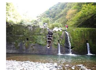
砂防堰堤の老朽化
