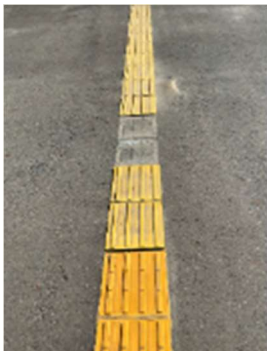
(点字ブロックの剥がれ)
