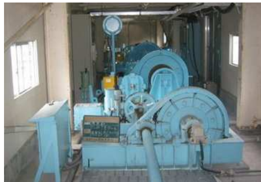
写真2 ゲート開閉装置(機械設備)
