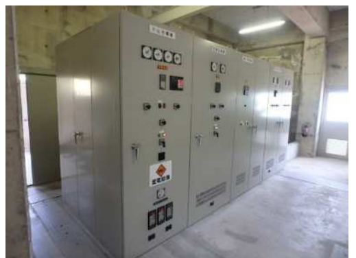
写真4 受変電設備(電気通信設備)
