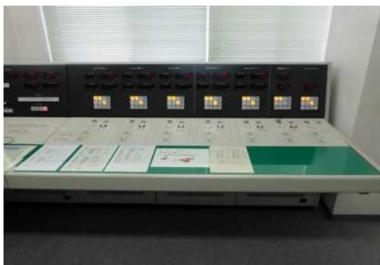
写真3 遠方手動操作卓(電気通信設備) (ゲートの開閉を操作する設備)
