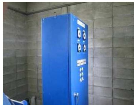
写真-4 規則操作盤
