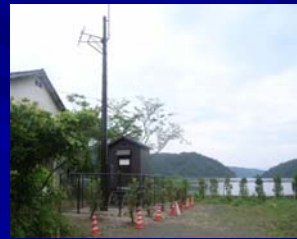
三方湖水位観測所 (田井地先) 平成21年度設置
